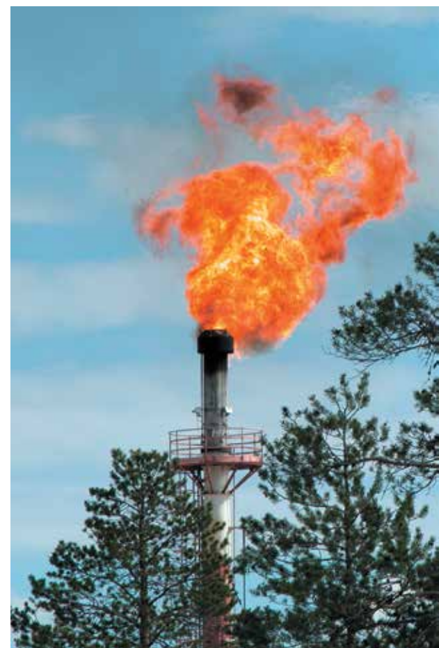
Газовая факельная установка на Вынгаяхинском месторождении. ► Фото автора
